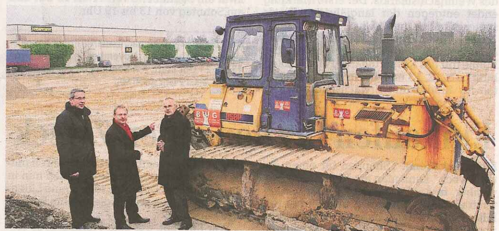
Der Boden für den Neubau auf dem Naberthermgelände wird vorbereitet. Friedrich-Wilhelm Wentrot und Detlef Thoden informieren Bürgermeister Willy Hollatz (rechts) über die Pläne.
